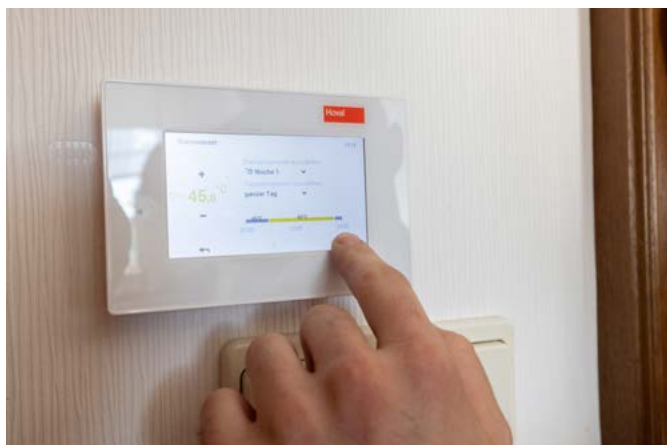
Les températures de chauffage et de l'eau chaude se règlent très facilement via TopTronic®.
