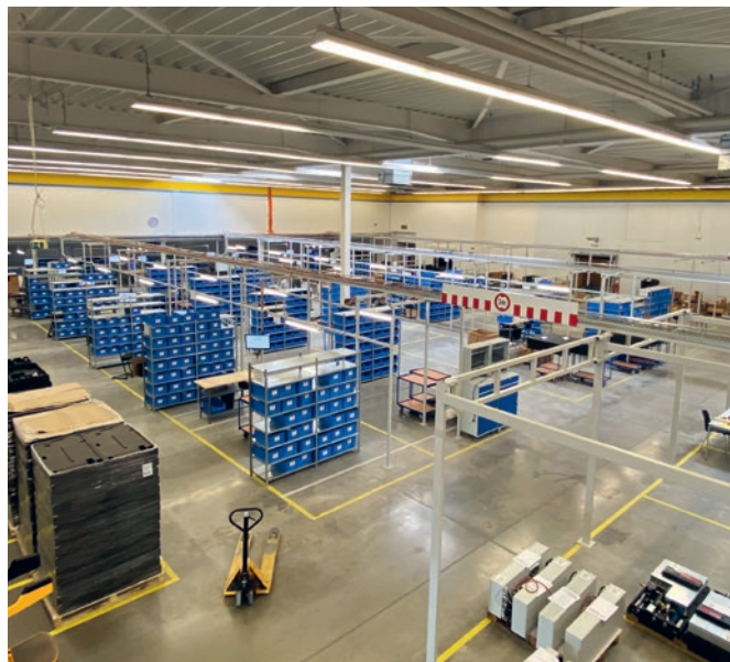
Montage des armoires électriques pour les pompes à chaleur Hoval dans la nouvelle usine 2 de YADOS GmbH
