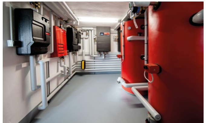
Dove erano installati i serbatoi del gasolio, ora trova posto un sistema completamente nuovo costituito in pompe di calore in cascata, moduli TransTherm® e accumuli di acqua.
