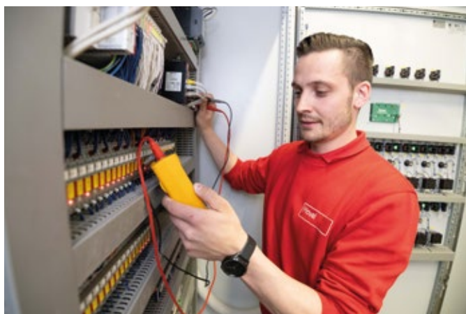
Hoval se charge de l'ensemble des réglages et de la technique de régulation.
