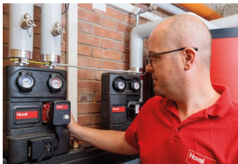
Le Bernois a l'esprit pratique et sait comment utiliser la chaudière BioLyt®.
