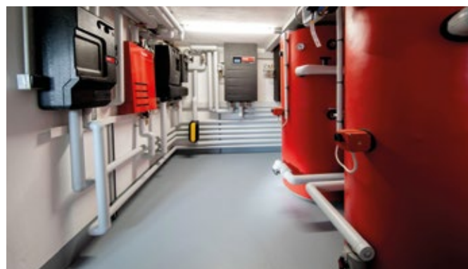
Là où des citernes à mazout étaient installées se trouve désormais un tout nouveau système composé de pompes à chaleur en cascade, de modules TransTherm® et d'un accumulateur d'eau.
