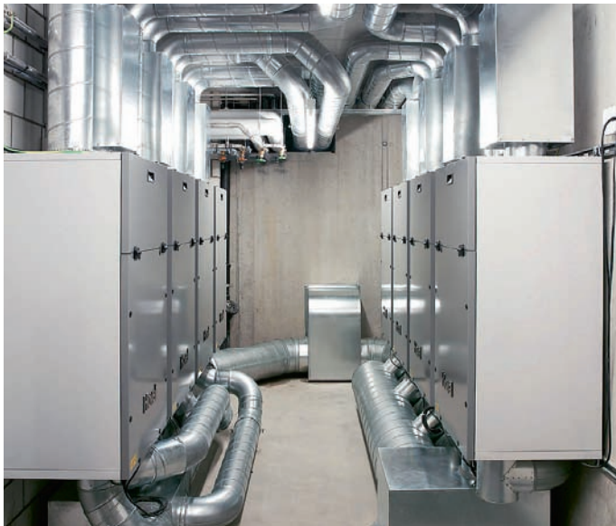
HomeVent-Lüftungsgeräte im Untergeschoss des Mehrfamilienhauses Wolfzangen
