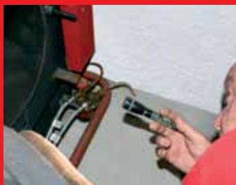
Kontrolle und bei Bedarf Ersatz von Anlageteilen.
