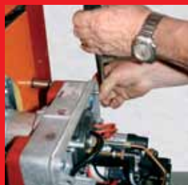
Reinigung, Funktionskontrolle und Einregulierung des Brenners.
